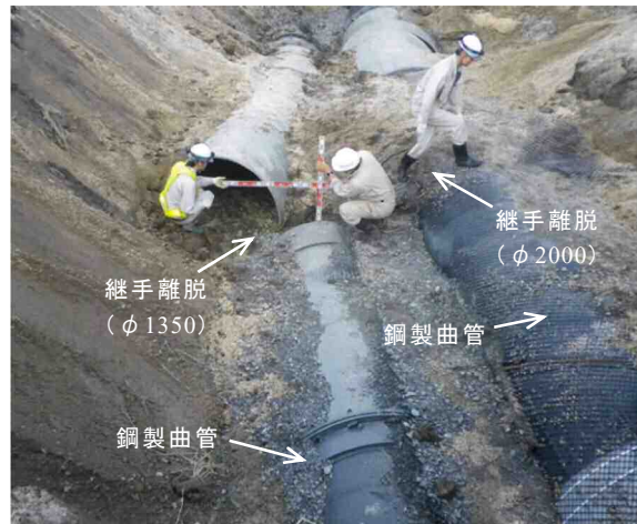
Fig.5 曲管部の移動に伴う管の離脱
